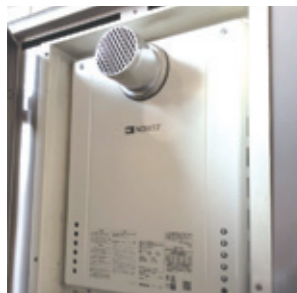
給湯器(工事後)
