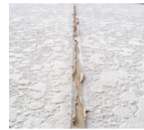
■目地部の剥がれ
