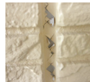
■目地部のクラック
